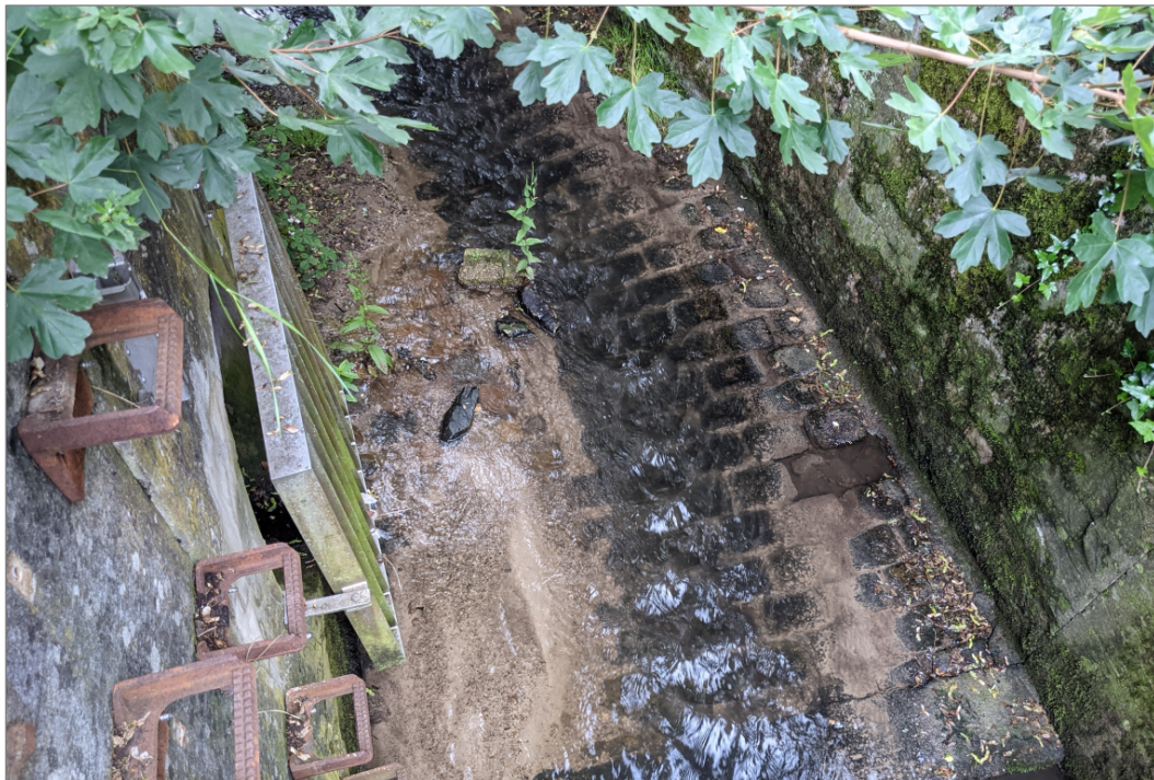
Abb. 5: Auslass einer Mischwasserentlastungsanlage (Foto: HLNUG, Wiesbaden)
